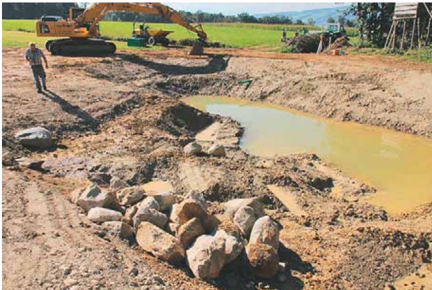
Nach den Aushubarbeiten füllt sich der neue Weiher langsam mit Wasser. Foto: Georges Müller
