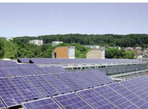
Vorbildlich: Photovoltaikanlage auf einem Flachdach eines Industriegebäudes in Lausanne.
