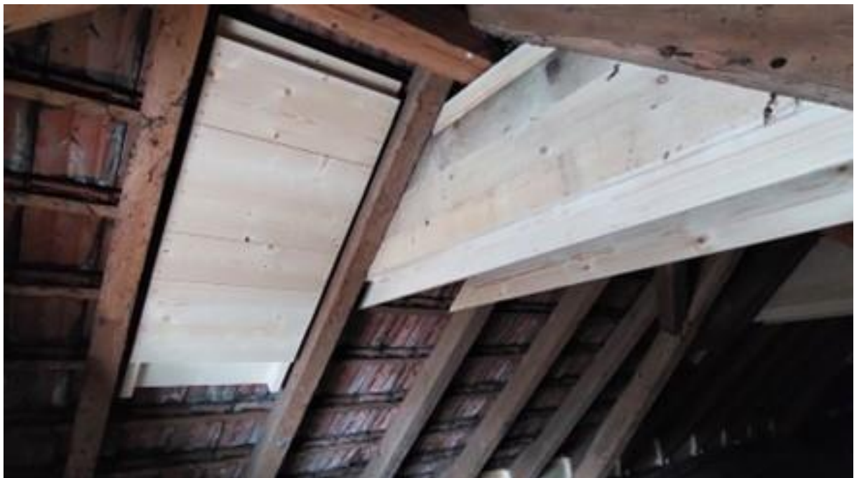
Im Dachstock des Gebäudes wurden zahlreiche Strukturen für Fledermäuse eingebaut. Foto: S. Ehrenbold
